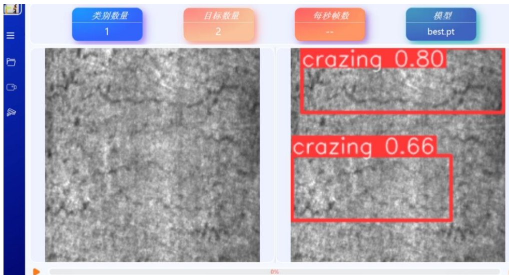
图 5-10 裂纹缺陷检测
