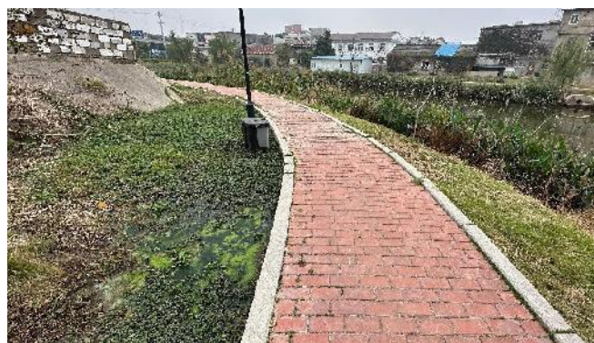
污水侵蚀地面
