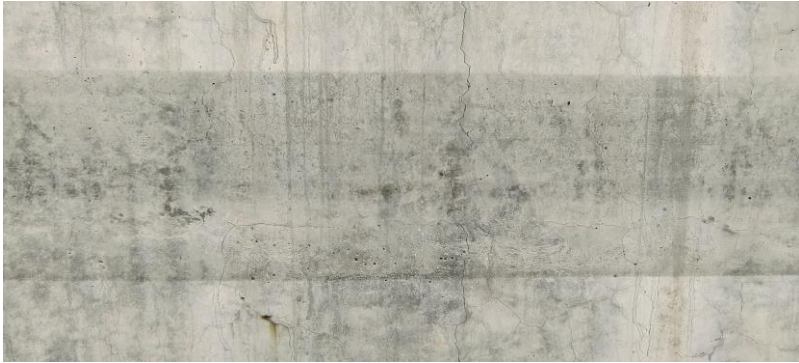
图 1-3 单轨梁走行面图像
