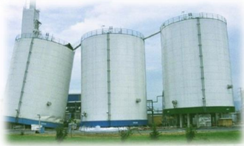
图 1-2 地震后倒塌天然气储液罐 (图片来源于网络)
