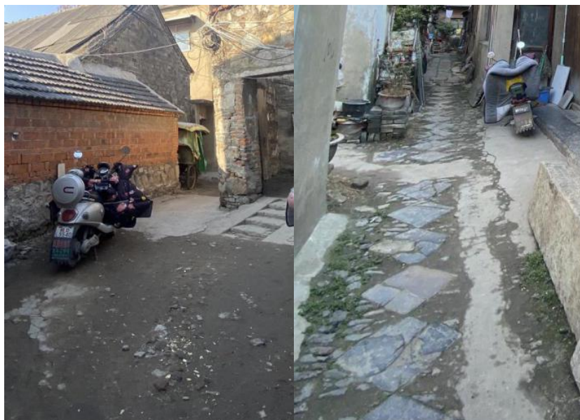
图 4-4 道路铺装破损
