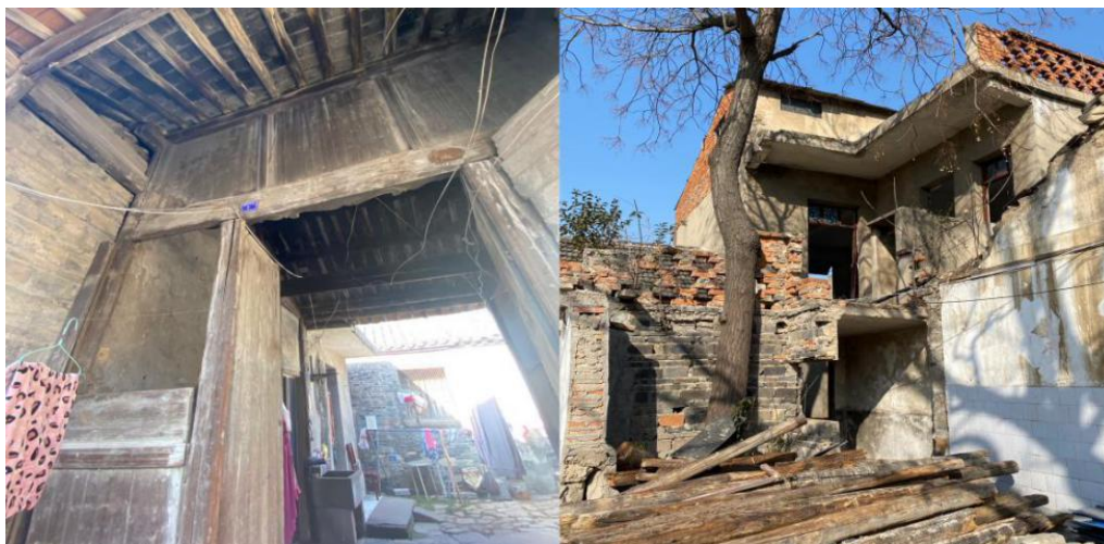
图 4-5 建筑损坏严重
